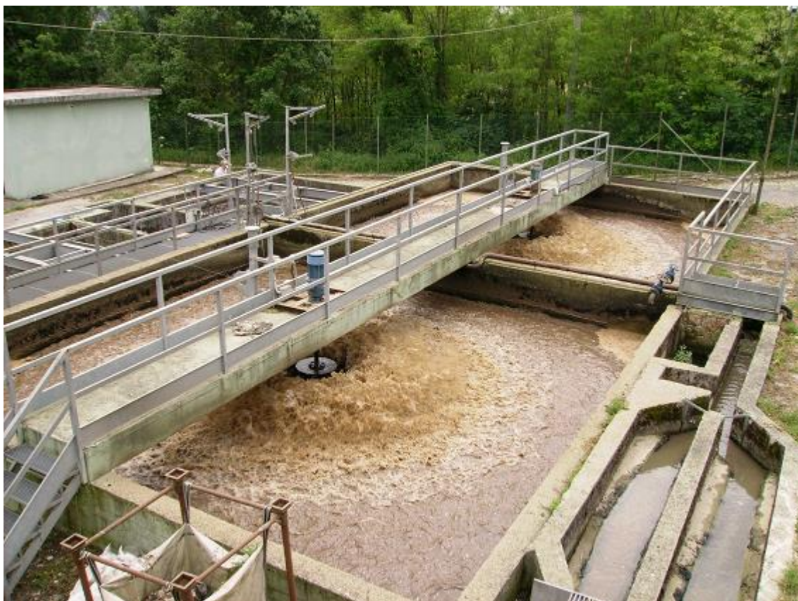
Figura 3 Impianto di S. Vincenzo Roccapivi: areatori superficiali in fuzione.
