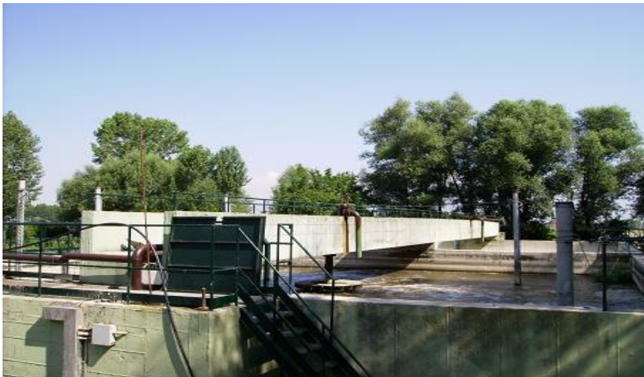
Figura 1 Impianto di Trasacco: flo-get in sostituzione di turbina superficiale guasta.
