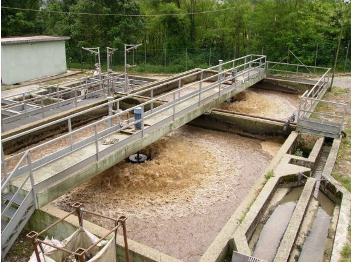
Impianto di S.Vincenzo Roccavivi: Areatori superficiali in fuzione.
